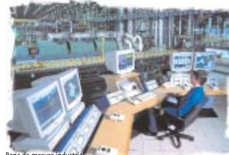
Banc de mesure industriel.
